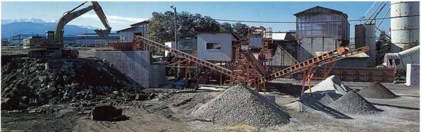
廃材解砕プラント
